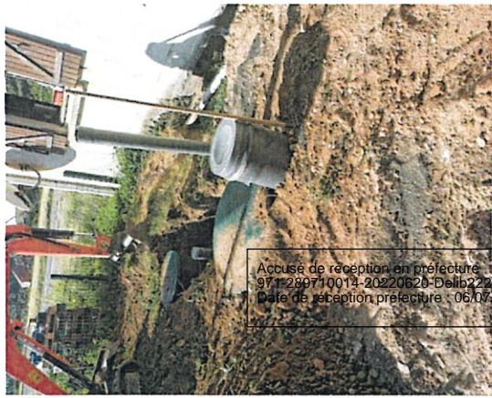
Fosse septique Terre de Bas
